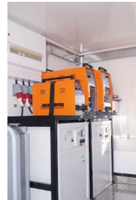
Стеллажи с оборудованием
