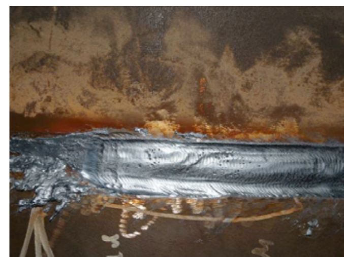
Визуализация дефектов. После выборки дефекты не «затираются». Они четко видны.
