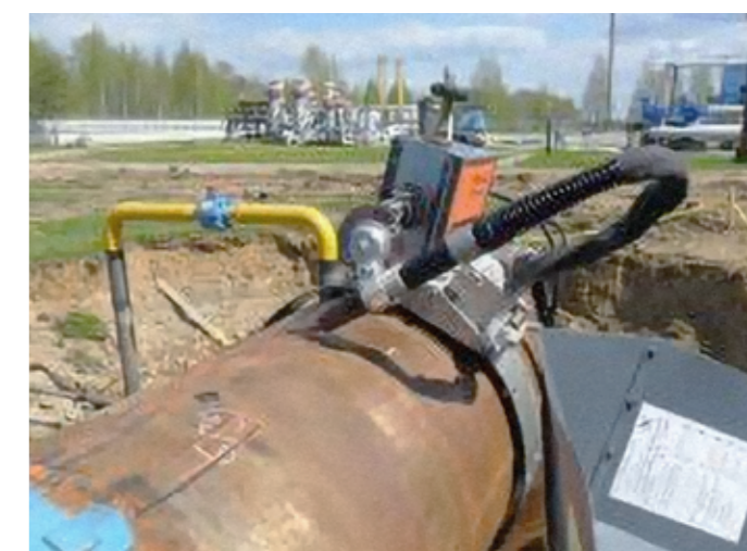
Выборка дефекта трубы Ø1420x36мм
