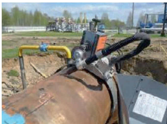
Выборка дефекта трубы Ø1420x36мм
